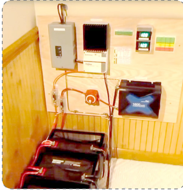
الشكل (2): محطة شمسية منفصلة عن الشبكة بجهد معياري 12 فولت
