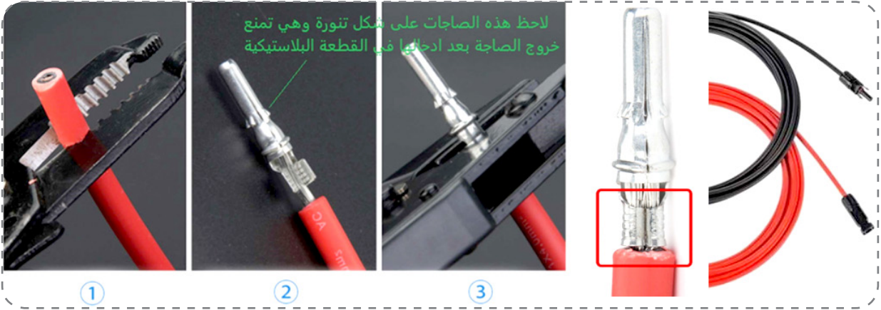
الشكل (6): خطوات تجهيز وصلات (MC4) المستخدمة لوصل كوابل الألواح الشمسية
